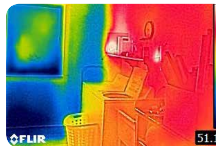
C2 – ŹŁE ZAIZOLOWANA ŚCIANA
